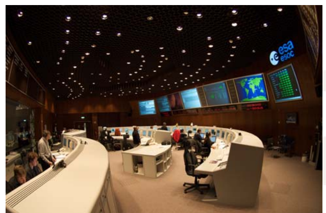
ESA/ESOC Main Control Room (Courtesy ESA)
